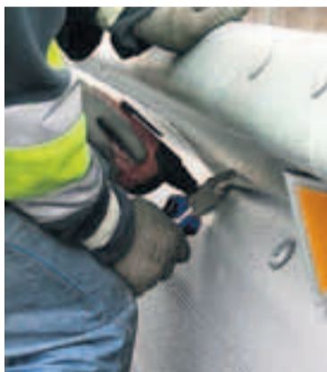
Guardarraíl con con sistema de protección. / EL NORTE
