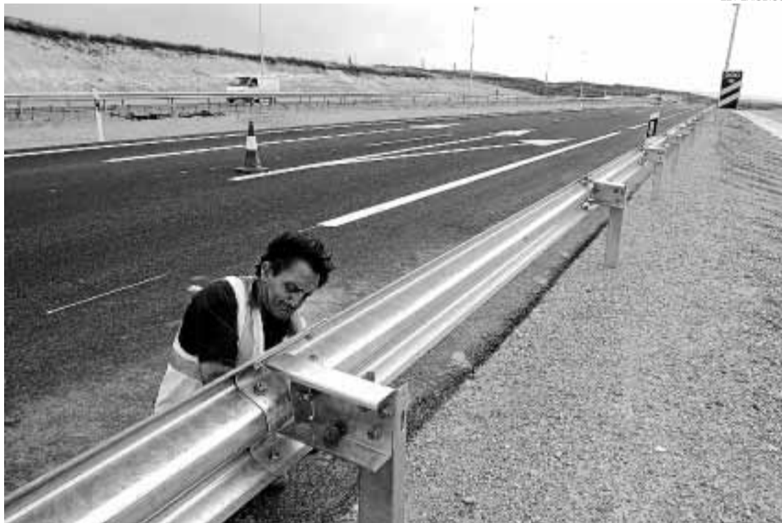
► Instalación de una valla quitamiedos en una ronda de circunvalación de Zaragoza.
